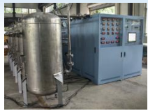
含氡尾气净化系统
